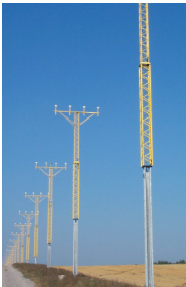
Figura 6 – Torres do ALS com mais de 12 metros de altura (Fonte: DOC 9157 – Part 6)
