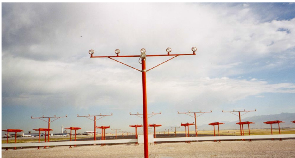
Figura 5 – Torres do ALS com estrutura tubular (Fonte: DOC 9157 – Part 6)
