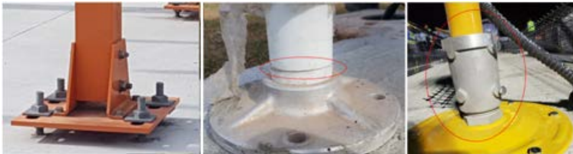
Figura 47. Exemplos de mecanismos de falha: parafuso fusível em base de antena de Localizer (imagem da esquerda); concentrador de tensão por redução de diâmetro em base de sinalização vertical (imagem ao centro); e acoplamento frangível em base de luminária de ALS (imagem da direita).
