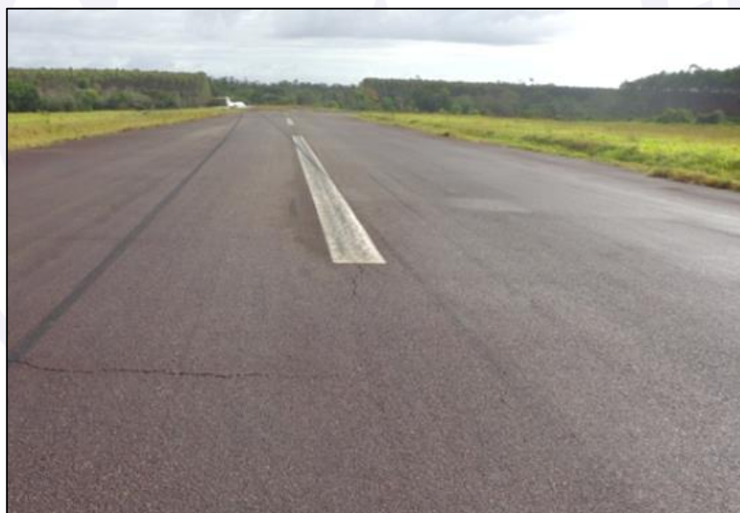
Figura 2 - Marcas da frenagem da aeronave.
