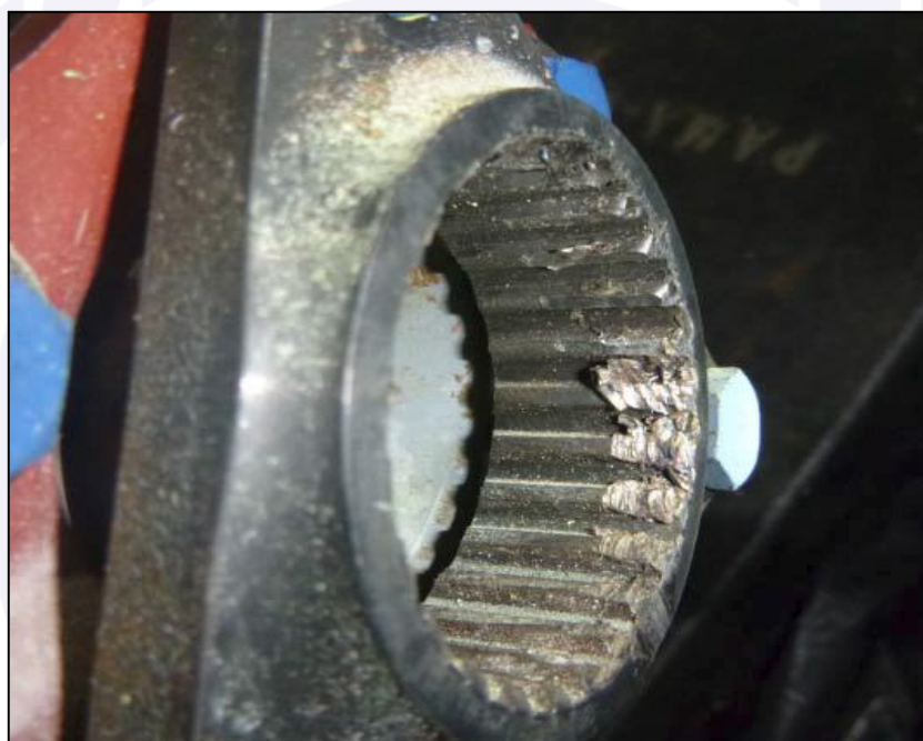
Figura 9 - Evidências de danos rotacionais nas estrias internas da flange do eixo do motor.
