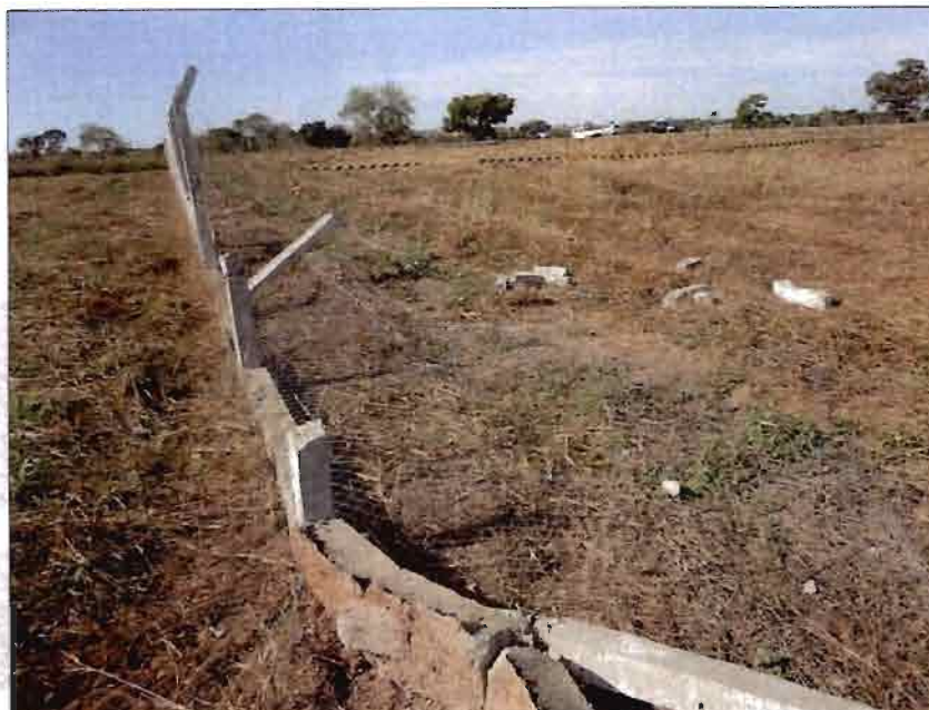
Figura 3 - Cerca de arame com pilares e alicerce de concreto derrubada pela aeronave.
