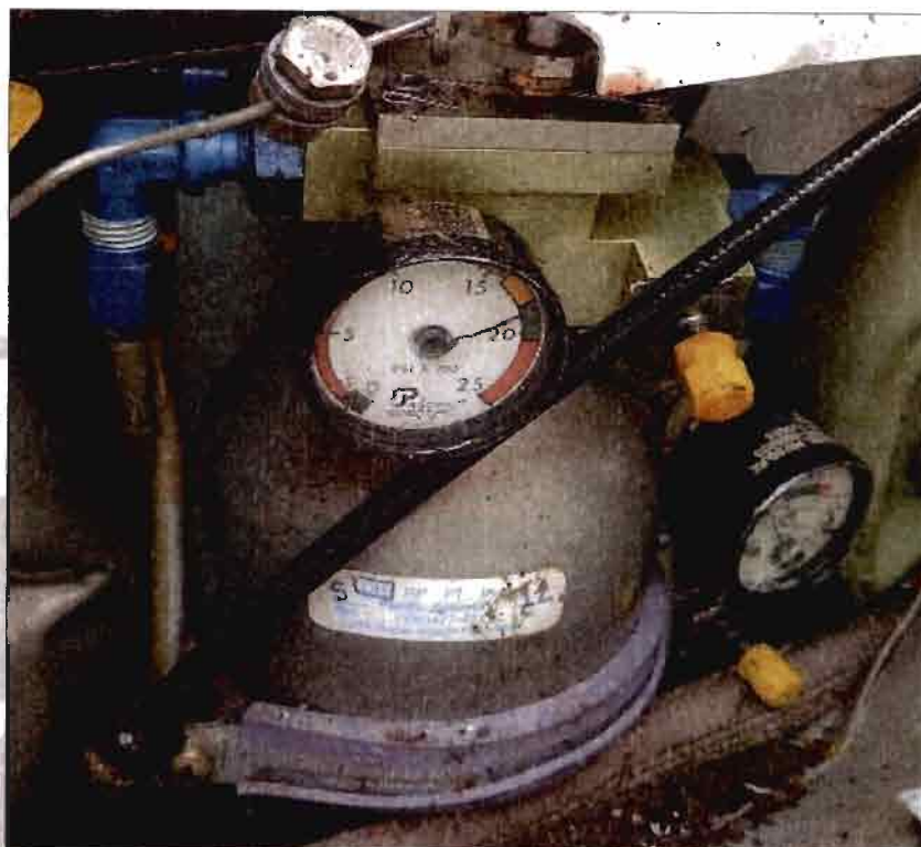
Figura 13 - Acumulador de nitrogênio do sistema de freio de emergência (faixa verde de 1.800 a 2.050psi).
