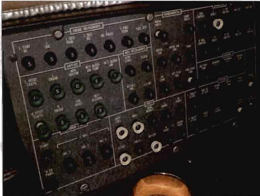
Figura 8 - Painel de disjuntores esquerdo.
