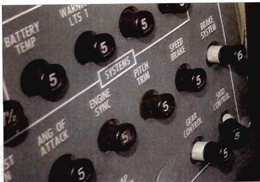
Figura 9 - Disjuntores desarmados - BRAKE SYSTEM, GEAR CONTROL e SKID CONTROL (SYSTEMS).
