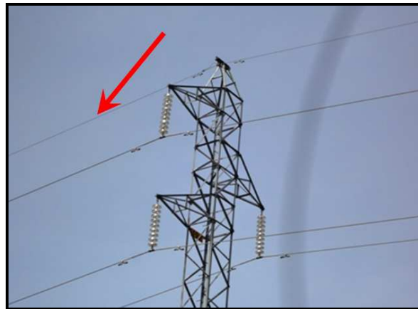
Figura 3 - Rede elétrica na qual ocorreu a colisão. Em destaque, o cabo guarda já reinstalado pela CEMAT.
