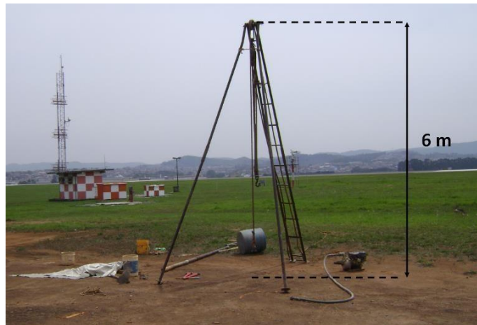
Modelo exato da torre de prospecção atingida pela aeronave.
