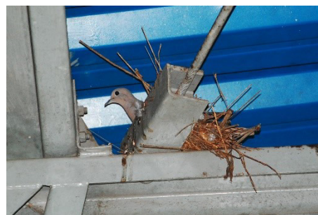
Figura 7 – Nidificação de aves em estrutura metálica (Crédito: Pilar Cozendey Silva)
