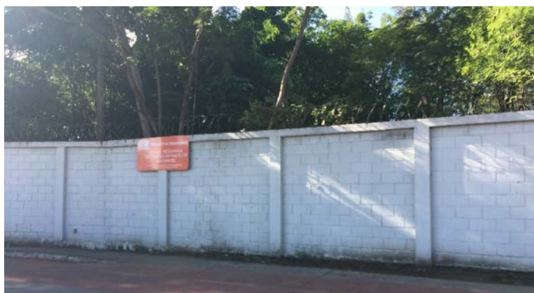
Figura 8 – Barreira de proteção constituída por muro em alvenaria com arame farpado no topo
