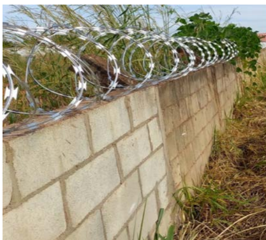
Figura 10 – Barreira de proteção constituída por muro em alvenaria com concertina no topo, dificultando a passagem de pessoas por cima, e enterrada no solo, impedindo a passagem por baixo
