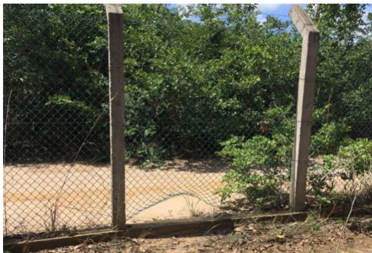
Figura 19 – Barreira de segurança com defeito – Abertura na parte inferior do alambrado permite passagem de pessoas e animais de pequeno porte
