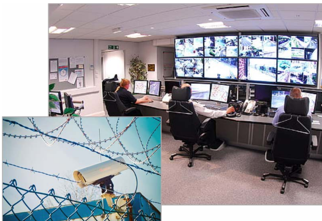
Figura 14 – Circuito Fechado de TV – câmera e sala de monitoramento
