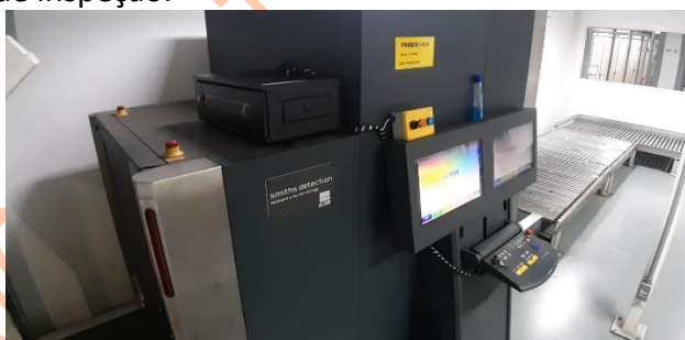
Equipamento IKONE instalado em Raios-x 1
