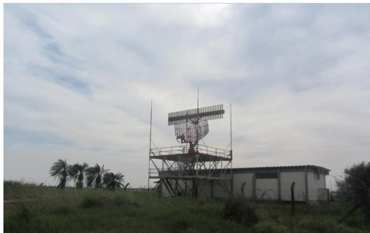
Figura 2-7 – Radar de aeródromo e respectiva subestação
