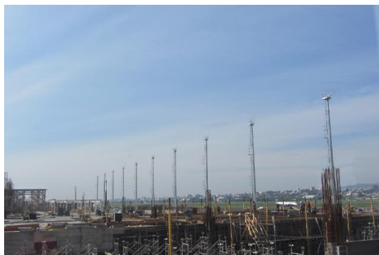
Figura 2-16 – Obras de ampliação do TPS-01 com vista para o pátio de aeronaves ampliado
