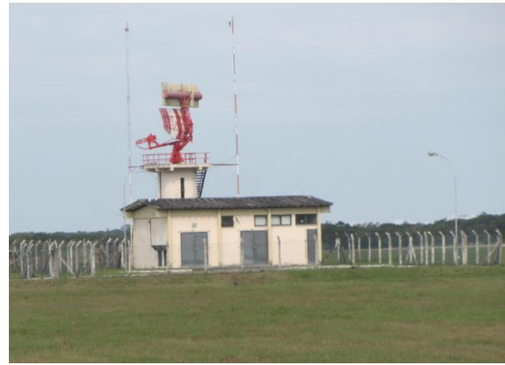
Figura 2-8 – Radar de Aeródromo
