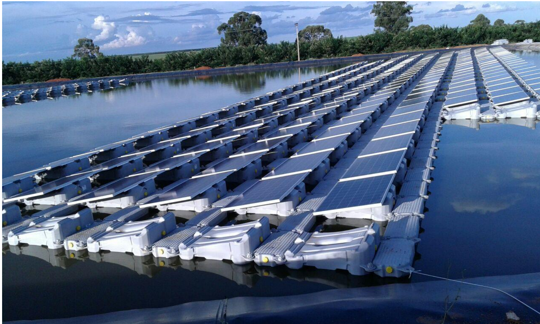
Primeira usina exclusivamente fotovoltaica flutuante do Brasil - Fazenda Figueiredo, Cristalina (GO)
