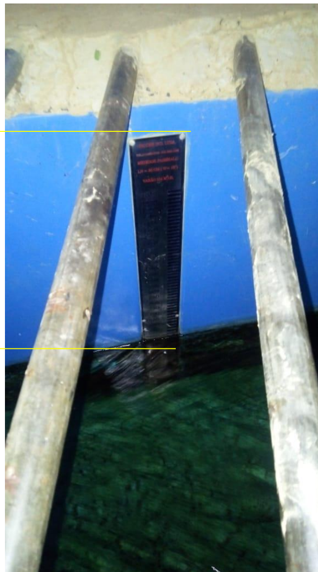
Calha Parshall 12" Maio 2019
