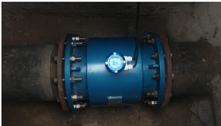
Medidor de vazão na tubulação de descarga para a bacia de dissipação
