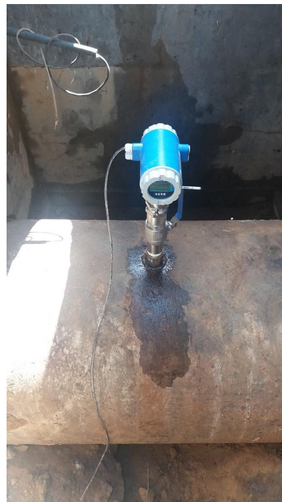
Medidor de vazão EMBASA
