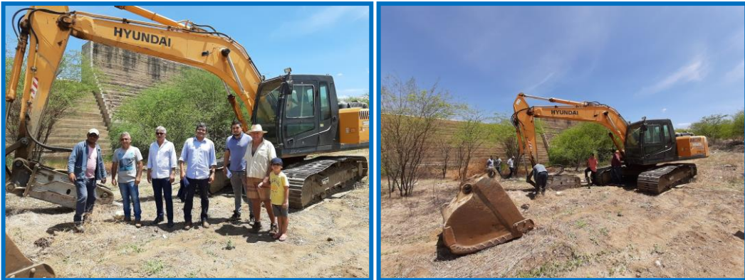
Visita técnica, in loco, promovida pelo Governo do Estado do RN, à Barragem Passagem das Traíras - Dia 15.01
