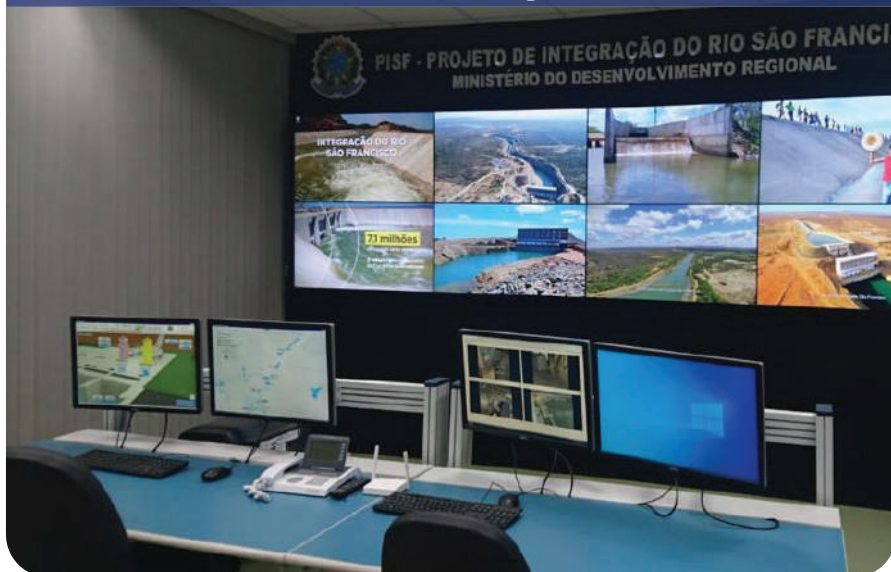
Núcleo de Controle Operacional do PISF, localizado na EBI-3 em Salgueiro
