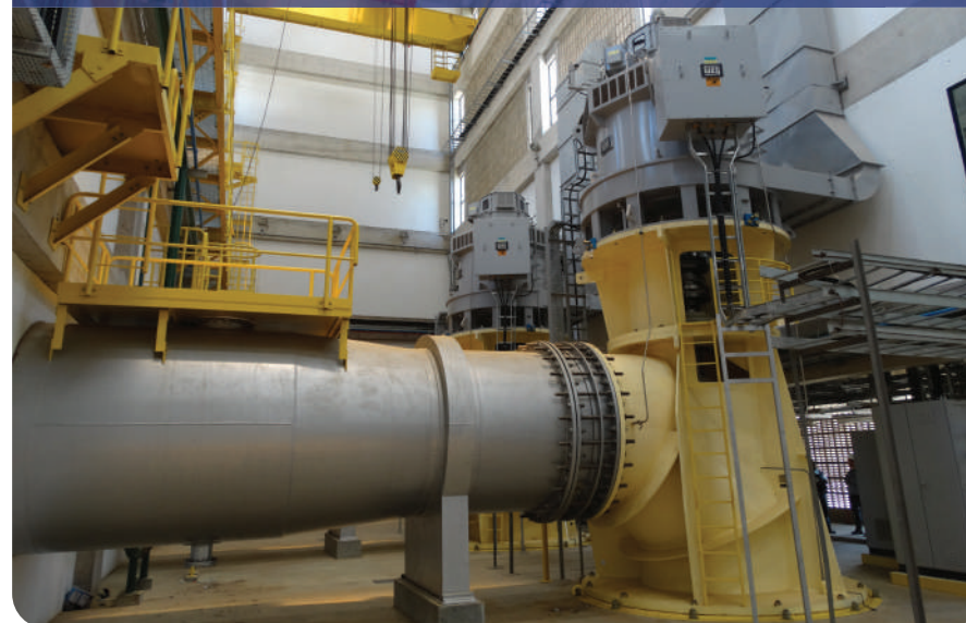
PISF Eixo Norte - Estação de Bombeamento EBI-1
