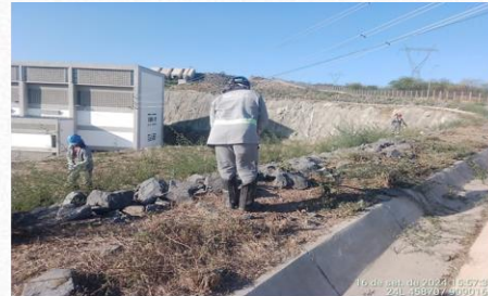
Estação de bombeamento EBI-2( WBS 1620)
