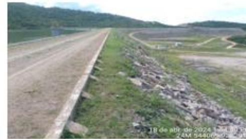
Reservatório Caiçara( WPS 1120)
