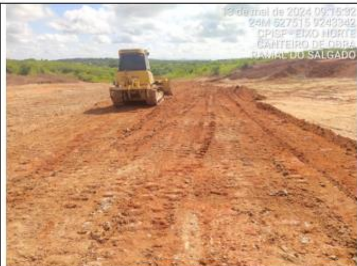
Foto 23: Visão atual do canteiro de obras do Consórcio ENGIBRAS/SMF. Espalhamento das camadas de solo lançadas para regularização do platô.
