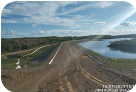
Reservatório Jati ( NPS 1111)
