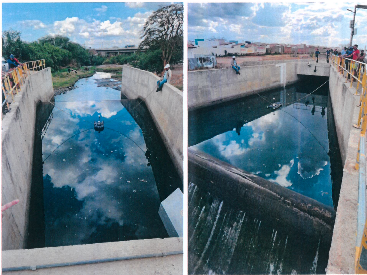
Figura 10 – Medições de vazão na Galeria de Monteiro realizadas pela APAC em 20 e 21/11/2023.
