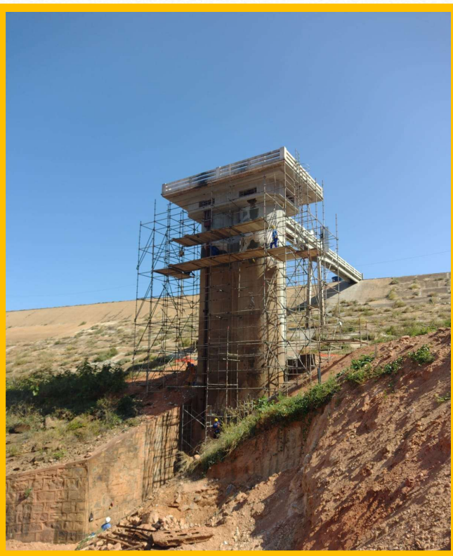
RESERVATÓRIO ENGENHEIRO AVIDOS/PB
