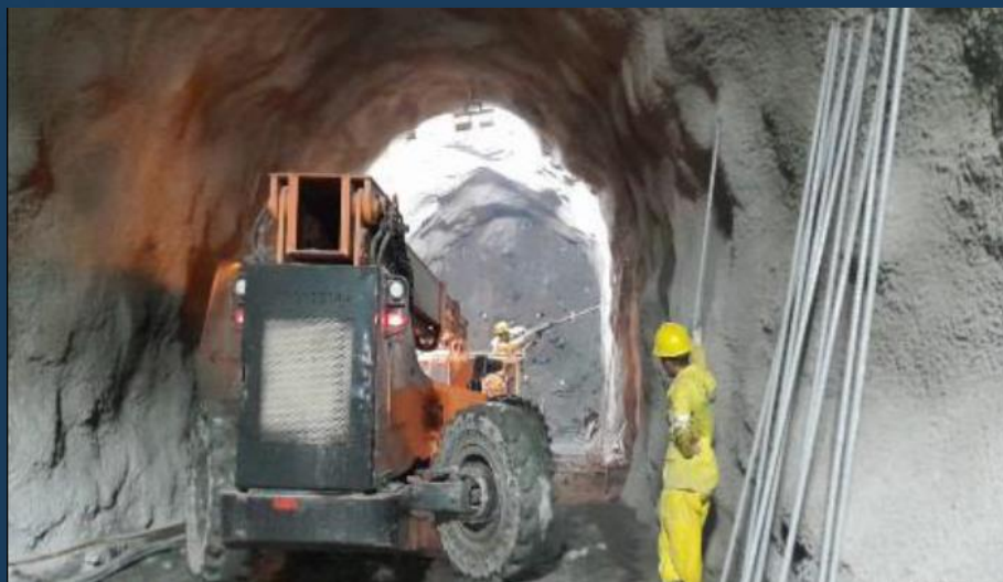
Túnel Major Sales: Execução da escavação com bate choco no sentido Emboque do túnel
