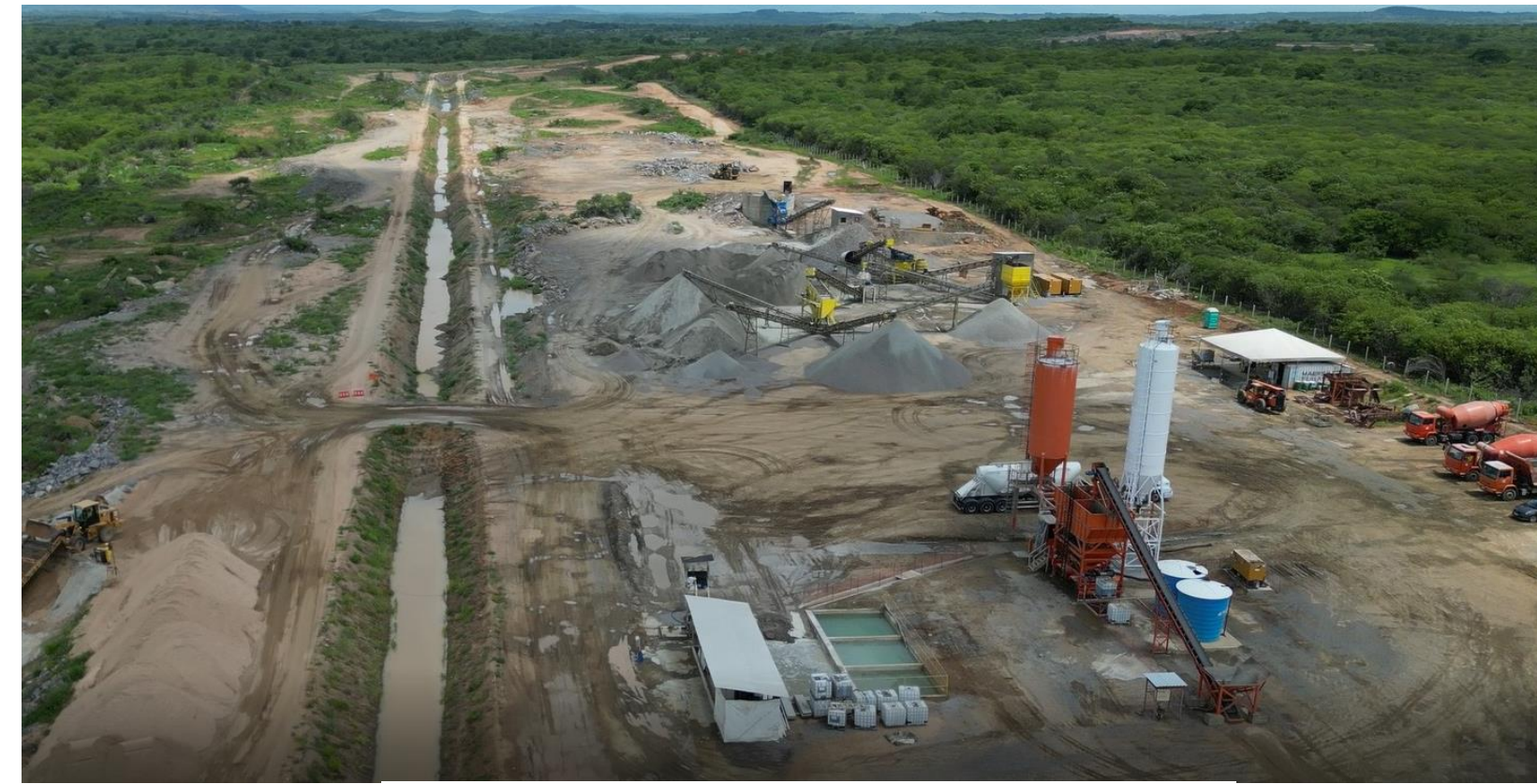
Canal C-7: Usina de concreto
