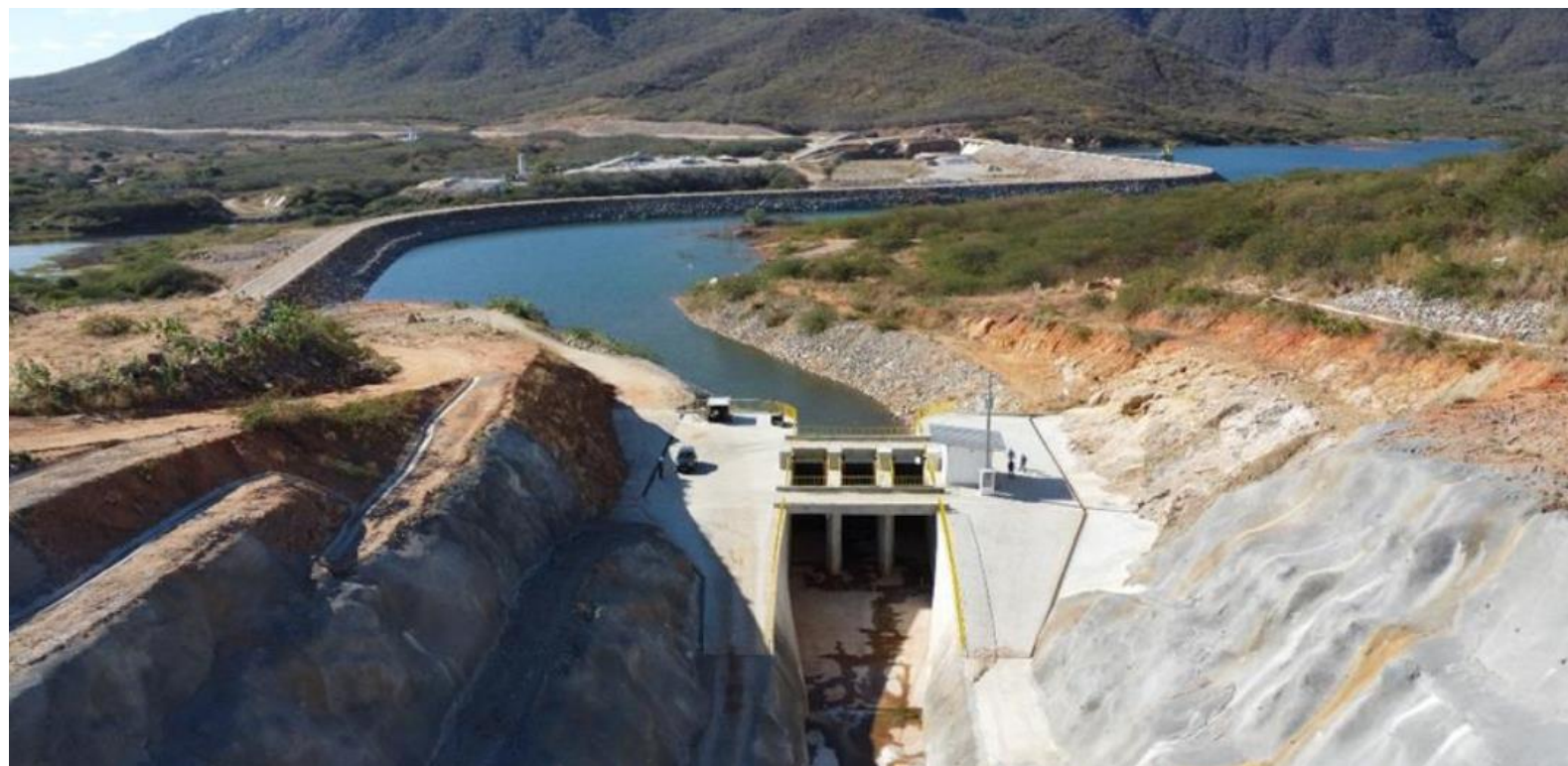
Estrutura de Controle Caiçara/Apodi
