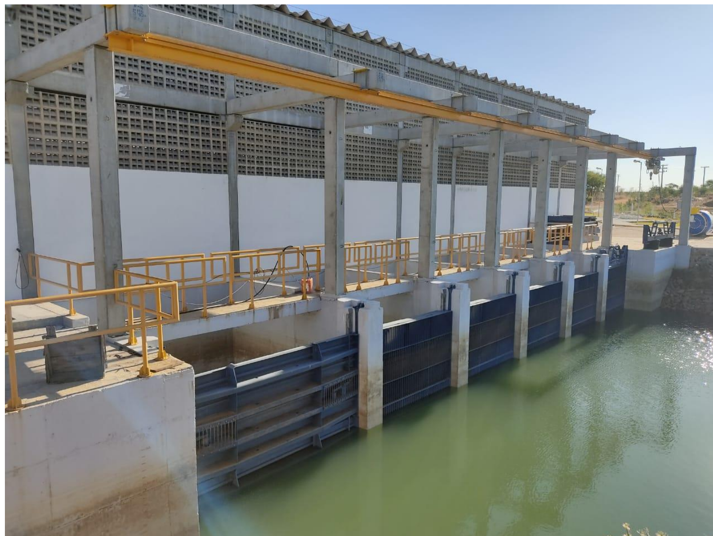
Moxotó (Compesa) Atendimento: Permanente Vazão Estimada: 0,3 m 3 /s Coord. UTM – SIRGAS 2000: E-671615 / N-9101539
