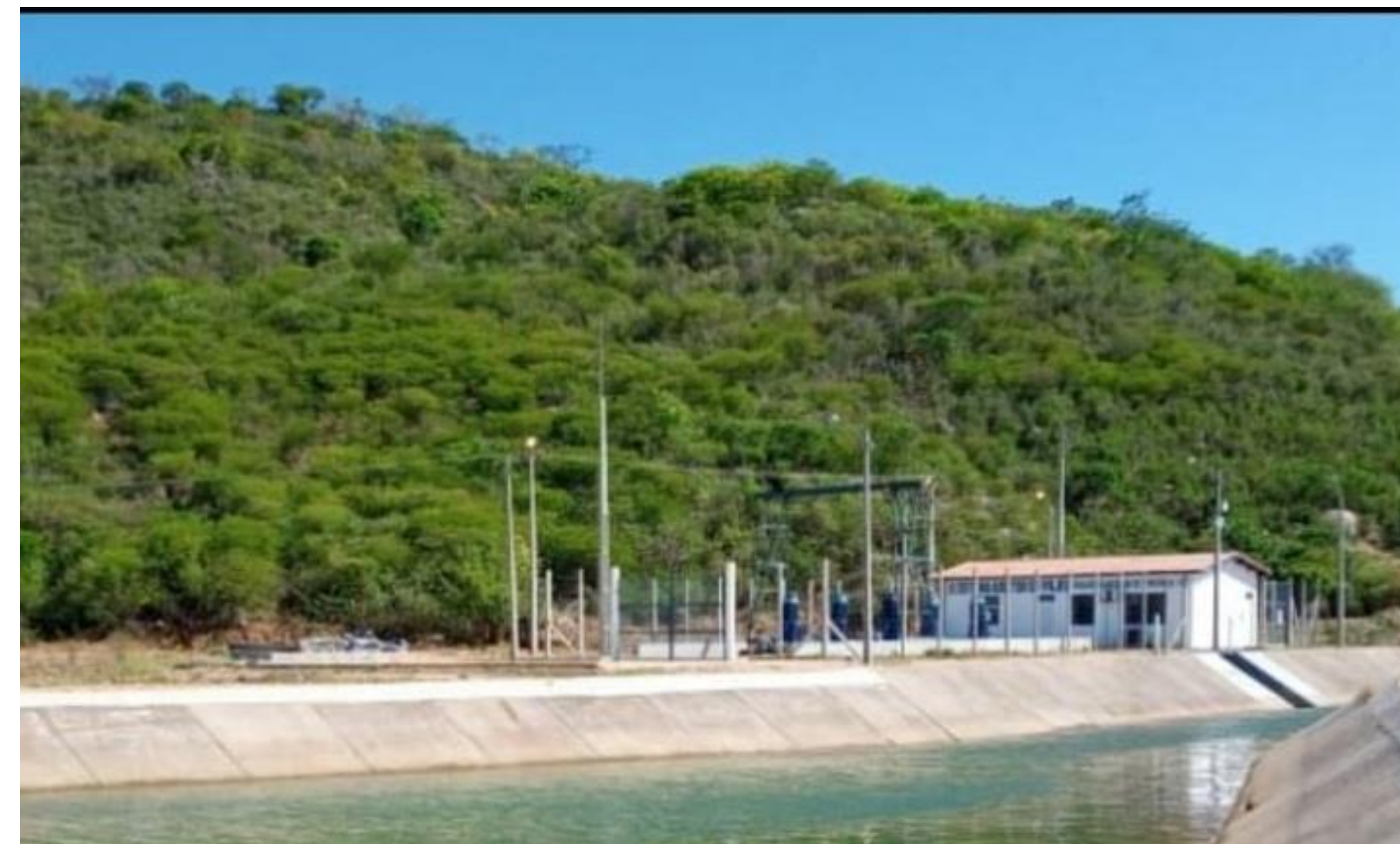
Pajeú (Compesa) Atendimento: Permanente Vazão calculada : 0,3 m 3 /s Coord. UTM – SIRGAS 2000: E-681353 / N-9108472
