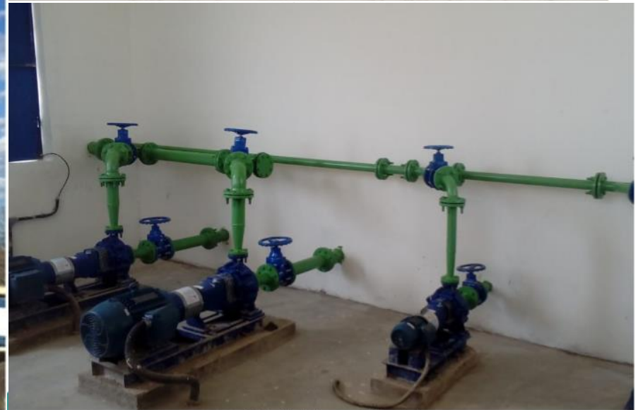
Foto 8: Estação Elevatória do Sistema Conceição das Crioulas.
