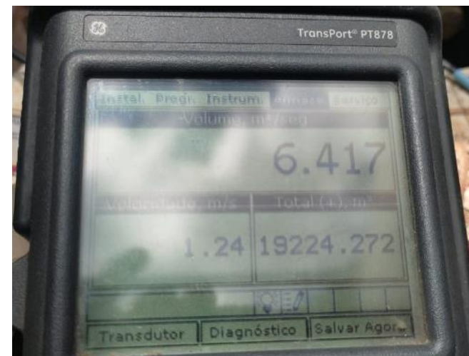
Medidor DNOCS: 6,417 m 3 /s abertura 15%
