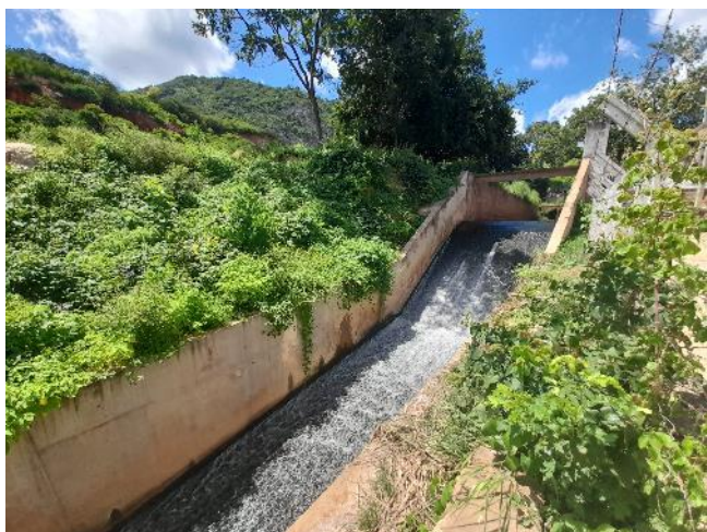
Captação CAGEPA Cajazeiras: tomada d'água do açude Eng. Avidos
