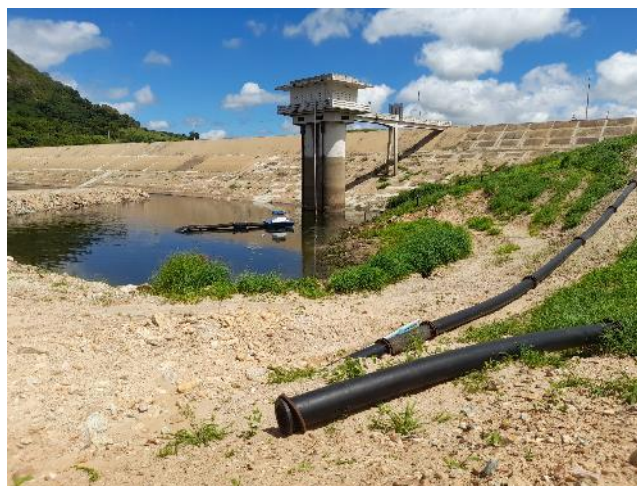
Tubulação da CAGEPA para captar água do reservatório sem bomba flutuante
