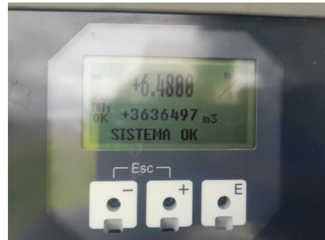
Medidor DNOCS: 6,480 m 3 /s abertura 15%
