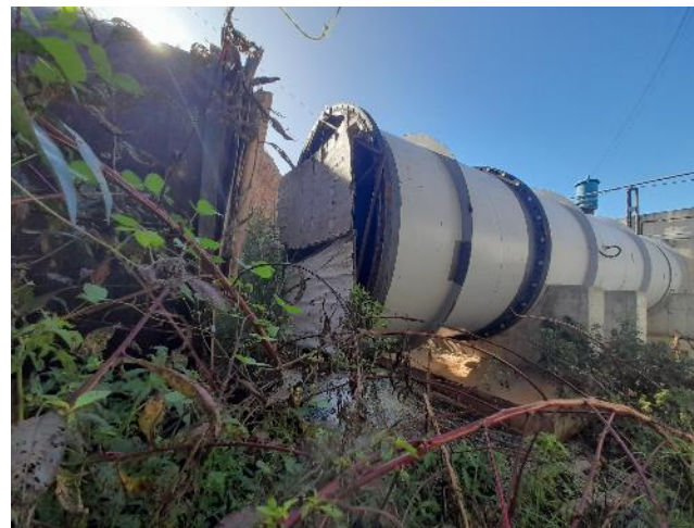
Uma das tubulações estava sem válvula borboleta (foi para conserto)
