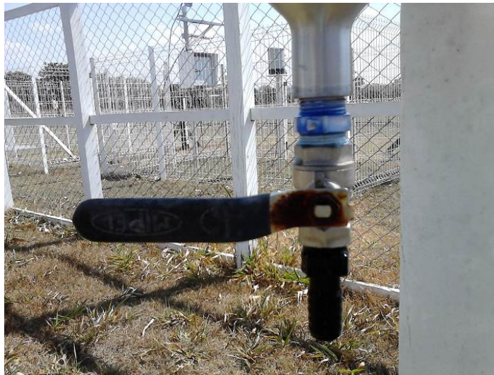
Figura 17: Detecção de vazamento na rosca da torneira do pluviômetro com o uso de corante
