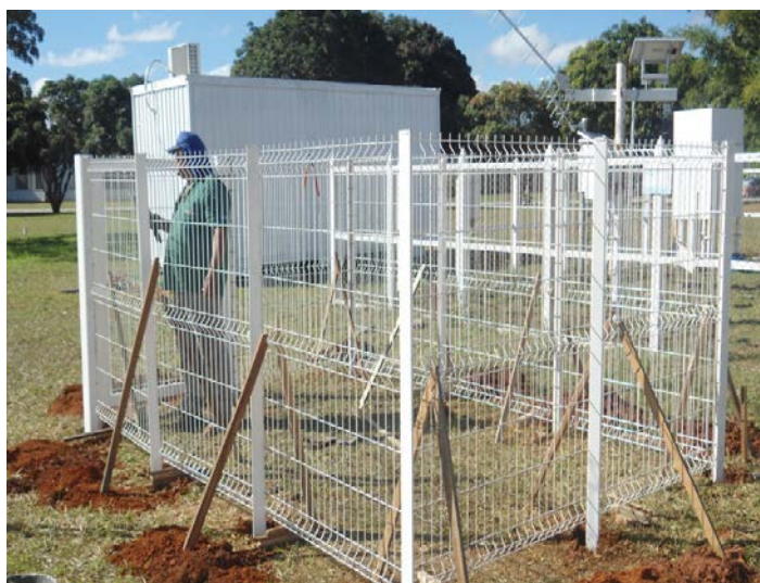
Figura I.9 Apoiar os painéis na vertical com ripas de madeira nos dois lados. Posicionar e instalar o portão. Devido ao seu peso, se necessário, amarrar o mesmo no poste (Figura I.10).
