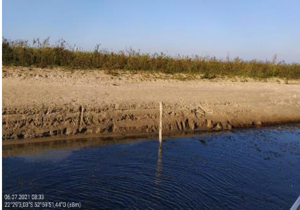
Figura 11 – Imagem do barranco ilustrando a redução de cota no Ponto 1, em 06/07/2021. Coordenadas: 22°29'3,03"S, 52°59'51,44"O.
