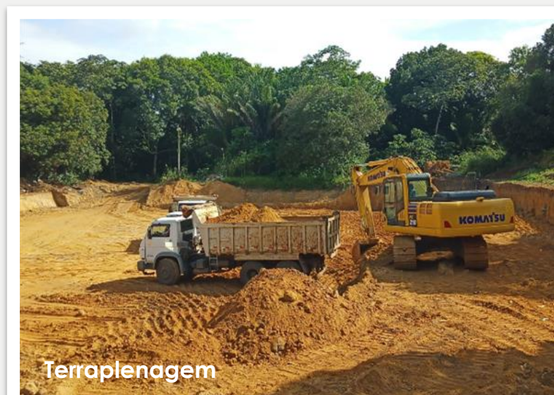
Captação adutora de Arataca II
