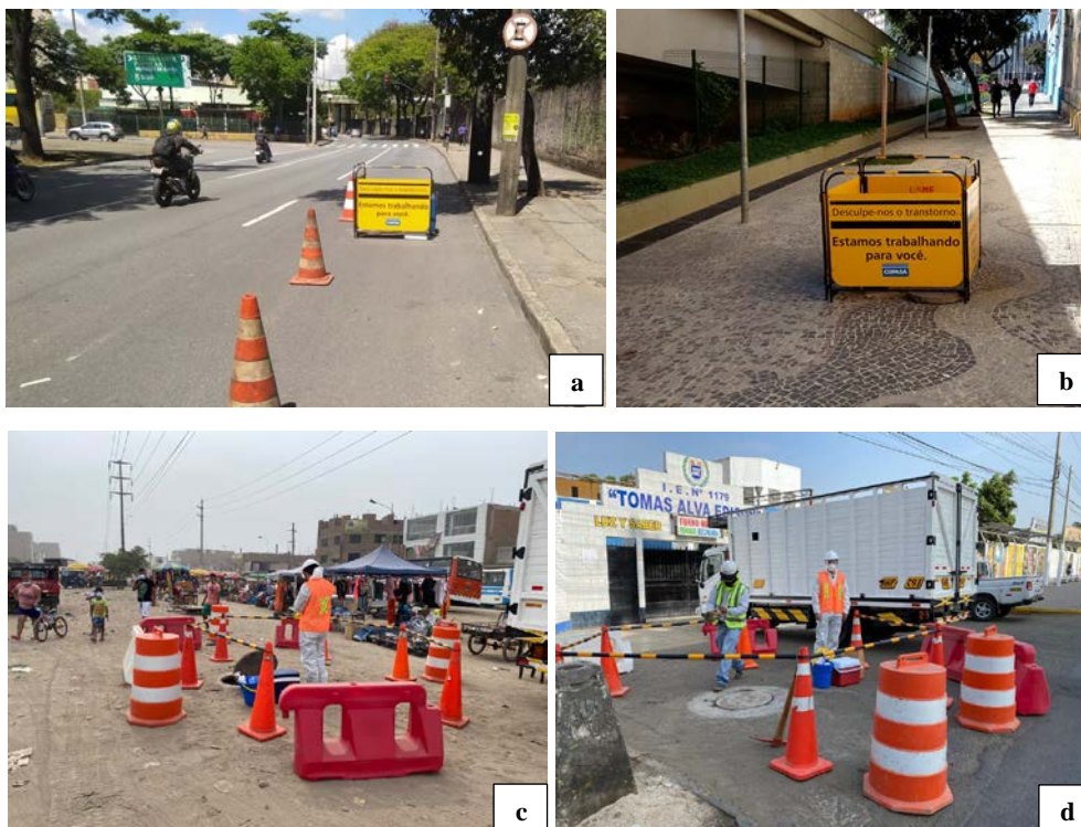
Figura 3: Tipos de isolamento adotados em função de diferentes condições de acesso aos pontos de monitoramento: (a) poço de visita em faixa de rolagem; (b) poço de visita em calçada de pedestres; (c) poço de visita em local de circulação irrestrita de pessoas e veículos; (d) poço de visita em local de estacionamento de veículos.
