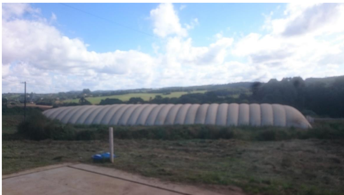
O biodigestor instalado tem capacidade de 4.175 m 3 de dejetos.
