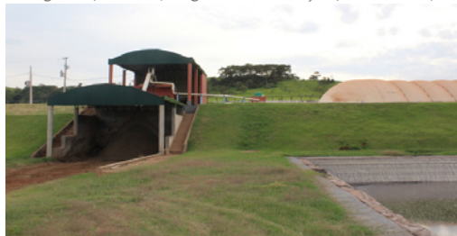
FIGURA 19 | Sistema de separação de dejetos (à esquerda), biodigestor (ao fundo) e lagoa de estabilização (canto direito).
