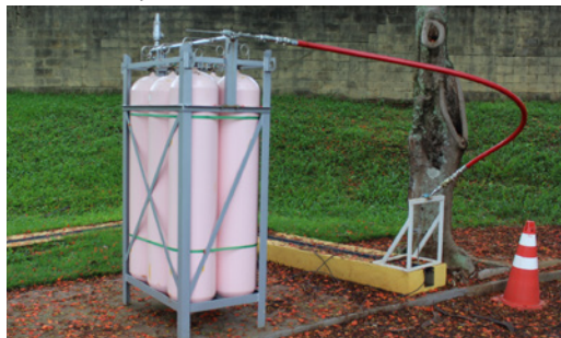
FIGURA 25 | Reservatório de biometano.
