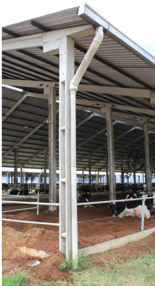
FIGURA 7 | Sistema de captação da água da chuva.
