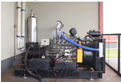
FIGURA 23 | Grupo gerador de energia elétrica através do biogás.
