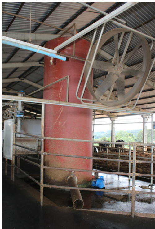
FIGURA 8 | Sistema para reuso da água na limpeza das instalações.
