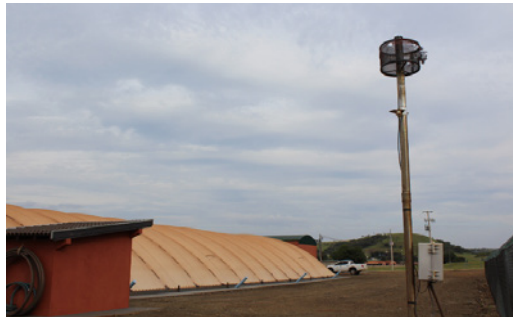
FIGURA 21 | Flaire (queimador). Utilizado na queima do biogás oriundo do biodigestor.
