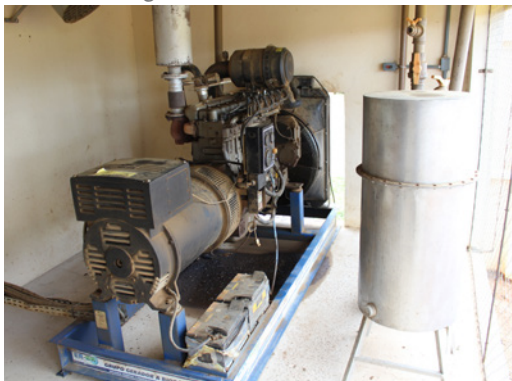
FIGURA 22 | Grupo gerador de energia elétrica através do biogás.
