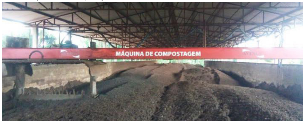
FIGURA 28 | Sistema de compostagem mecanizada.
