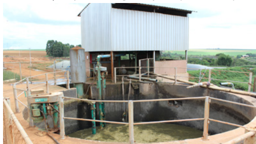
FIGURA 18 | Tanque de homogeneização e separador de dejetos.
