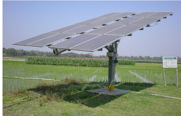
Sistema de irrigação, Itapipoca (CE).
