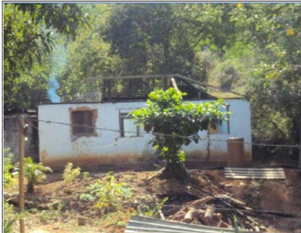
FOTO 01: Edificação de 28,05m 2 em alvenaria, sem telhado, em estado de abandono.
