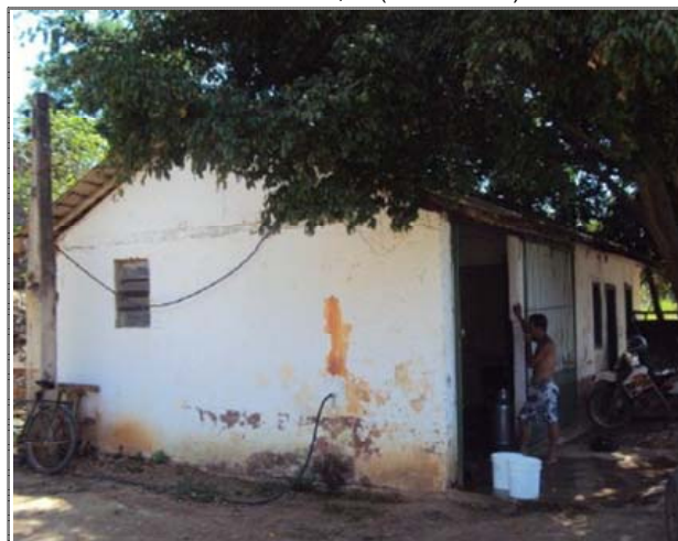
FOTO 22: Edificação em alvenaria utilizado como galpão de recepção de leite. Área 60,45m 2
