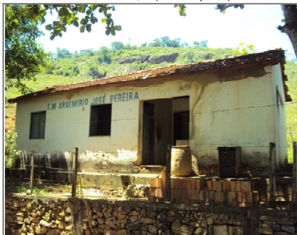
FOTO 17: Edificação utilizada como escola em alvenaria e telhado em telhas de barro. Área 55,59m 2 .
