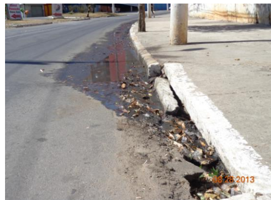
Fotografia 6: Água empossada no acostamento
