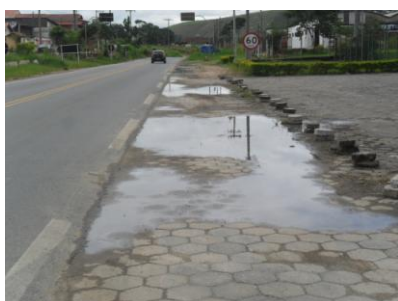
Fotografia 1: Água empossada no acostamento
