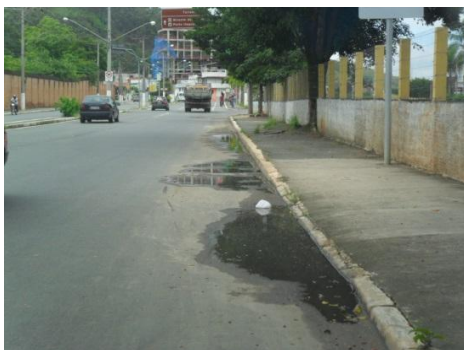
Fotografia 3: Água empossada no acostamento
