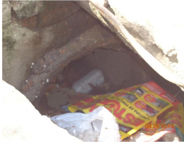
Fotografia 7: Água empossada no acostamento
